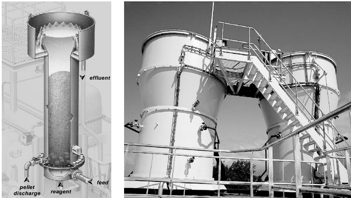
Bild 4.3: Prinzip des Crystalactor® und Ansicht der Reaktoren in Geestmerambacht (GIESEN und DE BOER, 2003)
